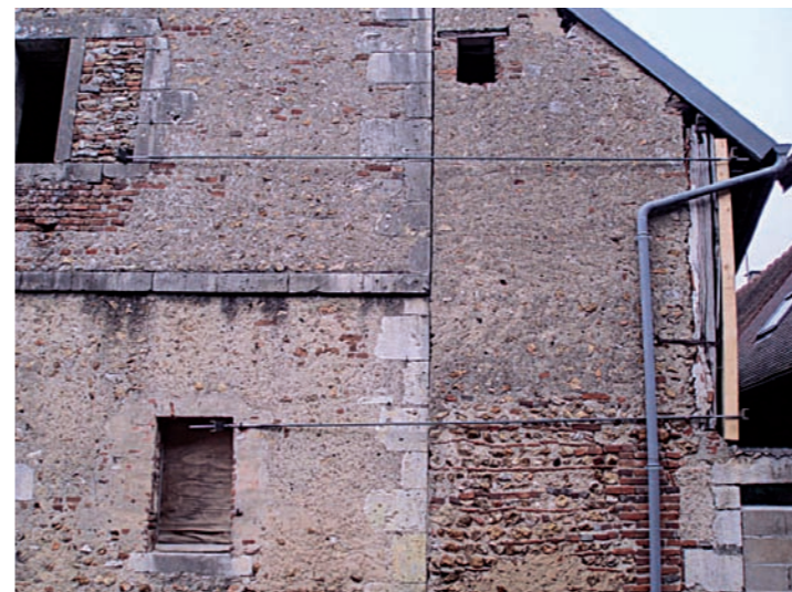
La Maison de Justice est désormais la propriété de la commune. En attendant sa restauration, le bâtiment a été étayé et ceinturé afin d'éviter un éboulement.
